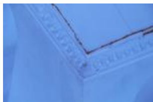
detal do renowacji
