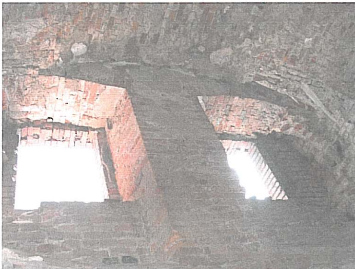
Wnętrza kazamat – rysy i szczelina powstała po odspojeniu muru elewacji E-E
