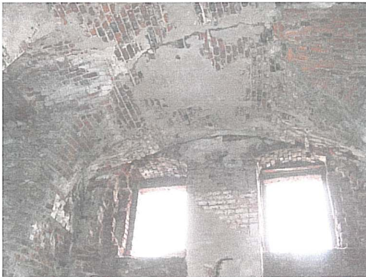
Wnętrza kazamat – rysy i szczelina powstała po odspojeniu muru elewacji A-A
